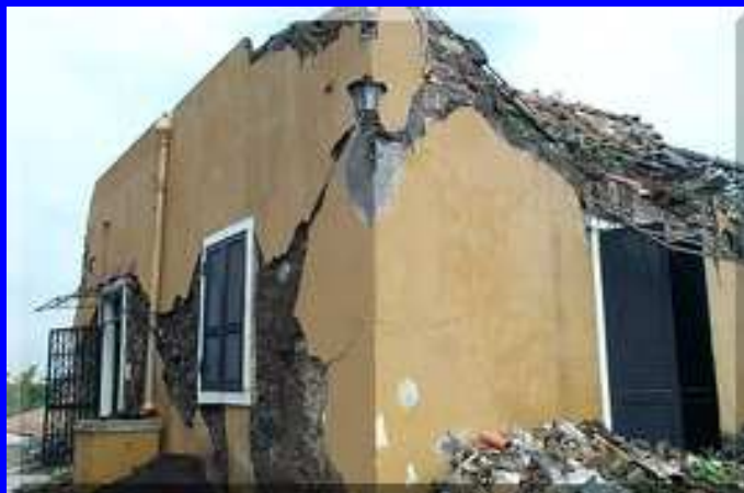
Acireale - Via Scura (San Giovanni Bosco): crollo di un edificio in muratura - Foto DRPC del novembre 2002 (A. Torrissi)
